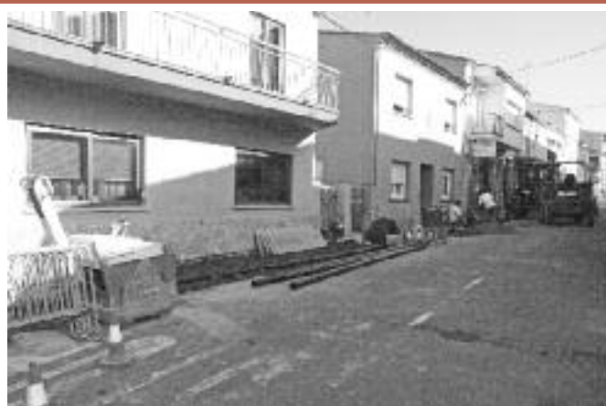
Urbanització puig de Sant Ramon. Sorea va iniciar el mes de maig els treballs del projecte de millora i soterrament dels serveis d'aigua potable, enllumenat públic, línies de baixa tensió i telefonia de la urbanització del puig de Sant Ramon, per un import de 1.517.509 €. Els treballs tenen una durada prevista de catorze mesos. Foto: L. Bruguera.
